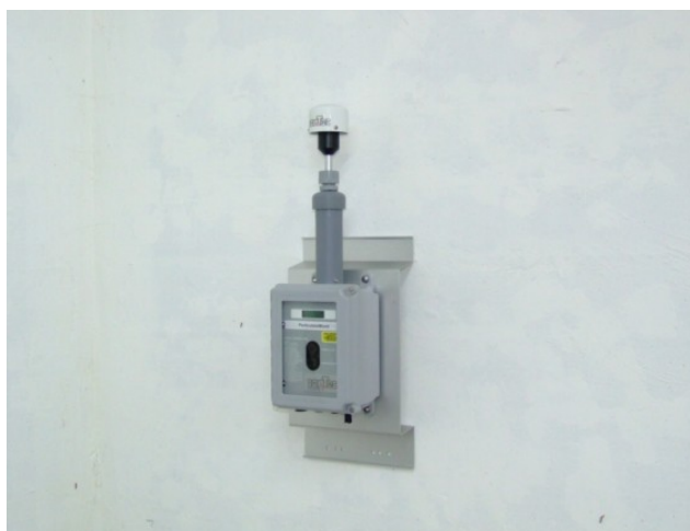
Installazione su parete di un ParticulateMonit
